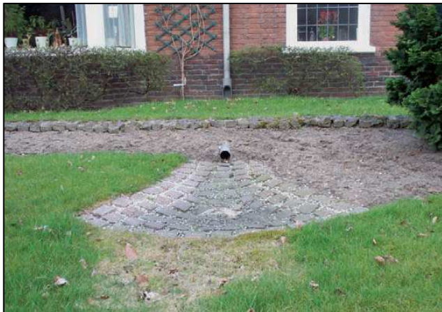
Figuur 25. Voorbeeld van een infiltratieveld.
