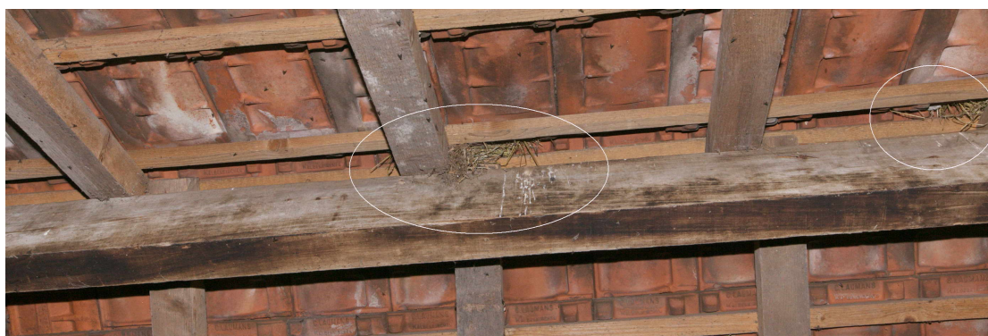
Figuur 10a: Huismusnesten onder de nokbalk (oostelijk deel, achter varkenskot).
