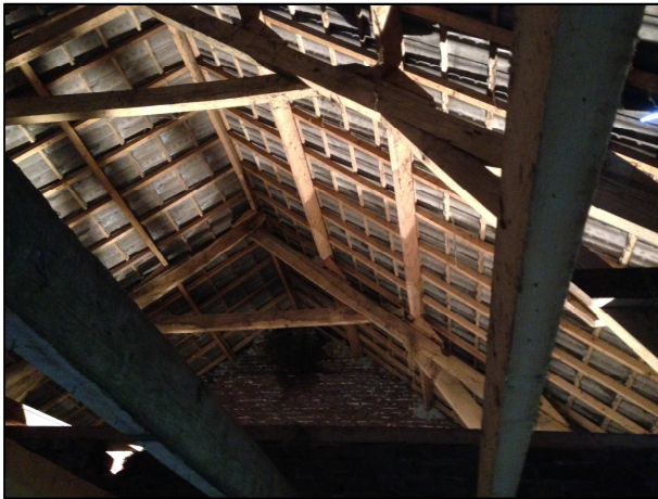
Foto 3. Dak van de boerderij, geen isolatie
