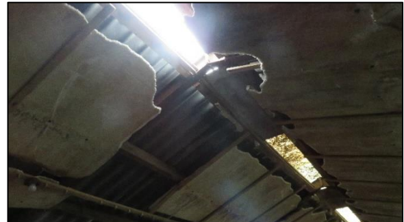
Foto 4. Gaten in de nok van het dak van de schuur
