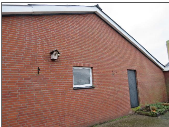
Foto 7. Buitenkant van stal met overhangende dakplaten en open stootvoegen op lage hoogte
