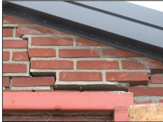
Foto 10. Scheuren en openingen in de muur van de stal
