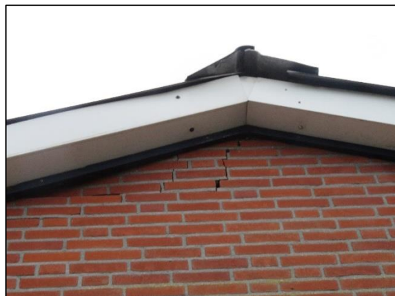
Foto 8. Scheuren en openingen in de muur van de stal
