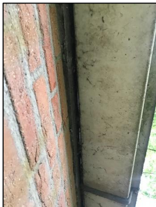
Foto's 18. Opening tussen dak en muur van het gebouw
