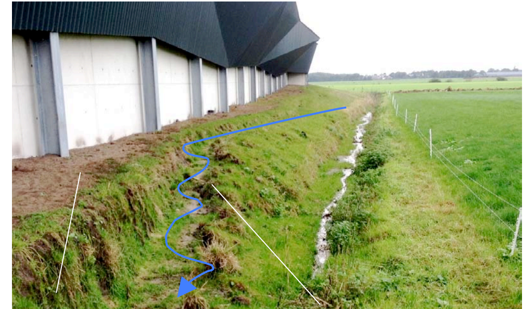
regenschaduw en erosie door afstromend water
