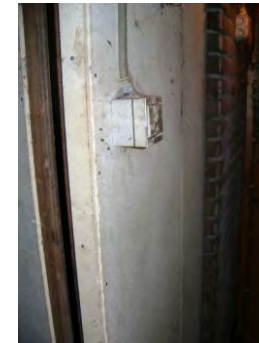
Foto 15. Asbestvrij brandwerend wandbeplating in cv ruimte gebouw D
