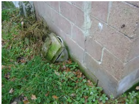
Foto 9. Asbesthoudende ac mestputingang voorzijde gebouw B
