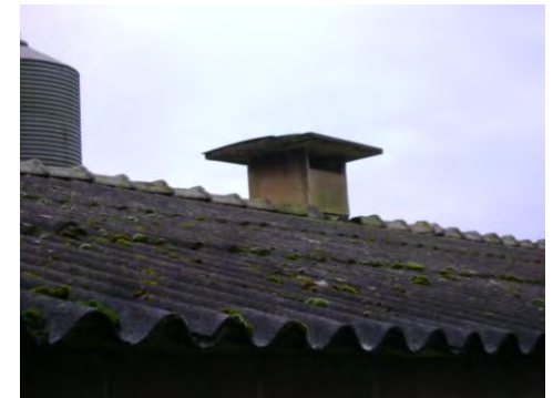
Foto 4. Asbesthoudende dakkokers van vl. plaat gebouw B en C.
