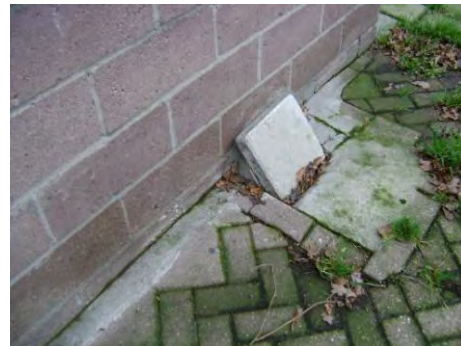
Foto 10. Asbesthoudende ac mestputingang voorzijde gebouw B
