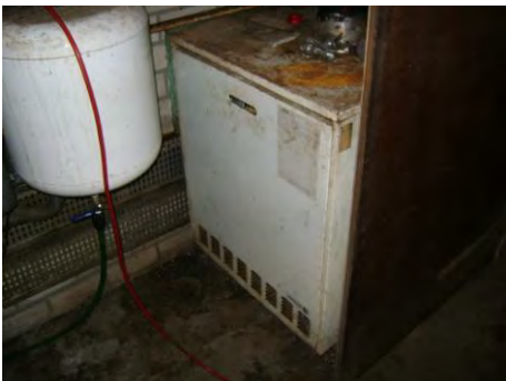
Foto 16. Asbestverdachte cv installatie in cv ruimte gebouw D
