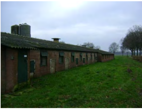
Foto 1. Asbesthoudende golfplaten, dak gebouw B en C.
