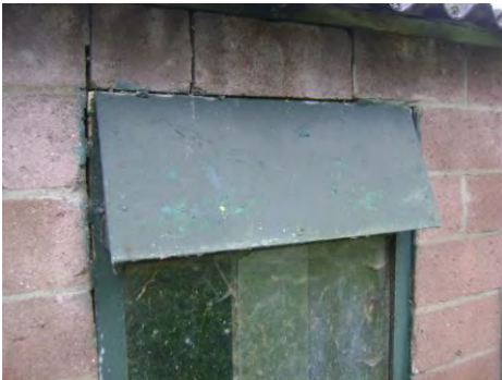
Foto 5. Asbesthoudende kappen van vlakke plaat gebouw B en C
