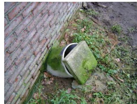
Foto 7. Asbesthoudende ac mestputingang achterzijde gebouw C
